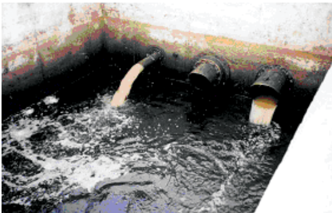
Abb.4 : Vermischung der Abwasserströme im Pumpwerk Prora
