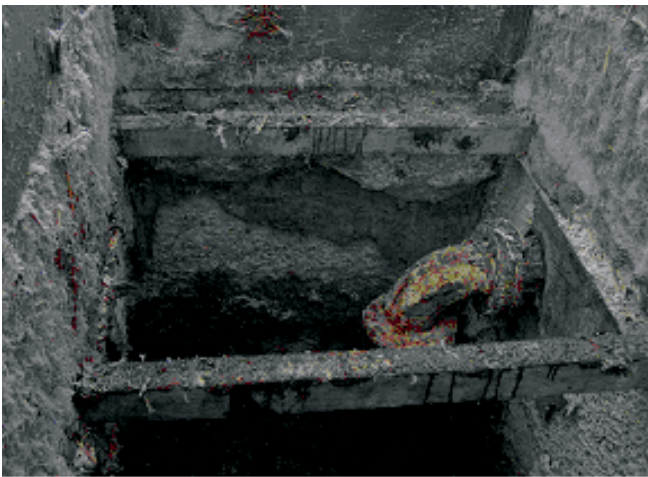
Abb. 1: Korrodierter Einstieg in einen Abwasser-sammler vor der Sanierung
