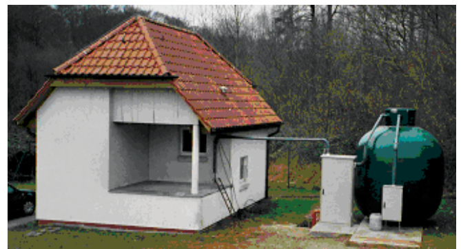
Abb. 2: Pumpwerk Sassnitz mit Dosierstation für Eisensalzlösung
