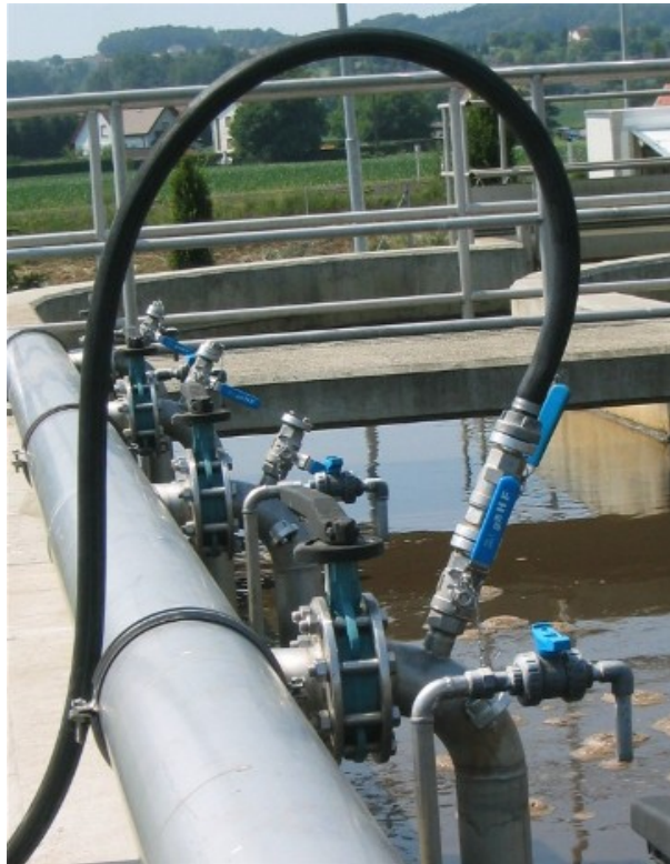
Abbildung 16: Anschlussstutzen zur Einbringung der Reinigungslösung
