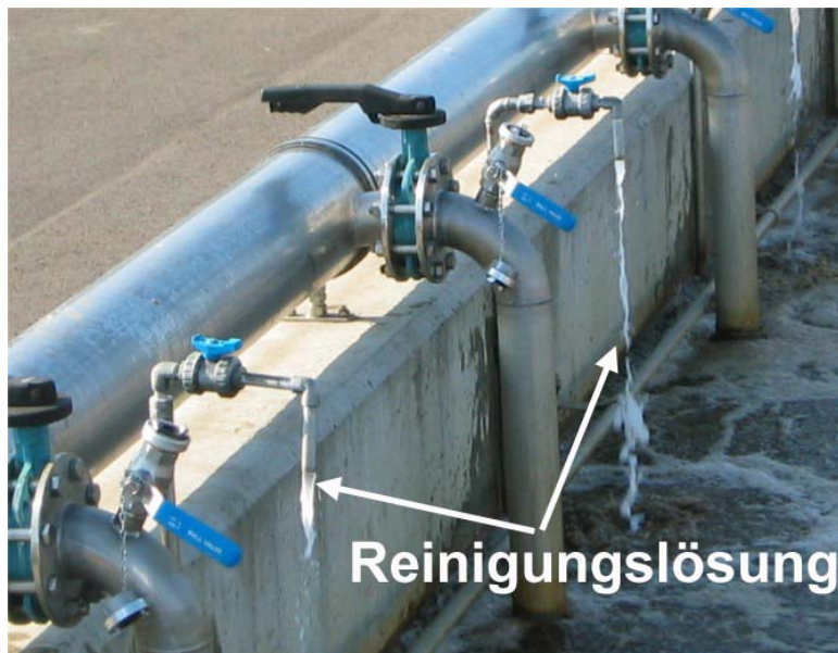
Abbildung 17: Entleerung über die Entwässerungsleitungen
