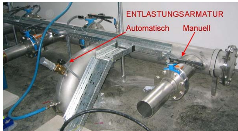
Abbildung 6: Installation zur Entspannung auf Umgebungsdruck
