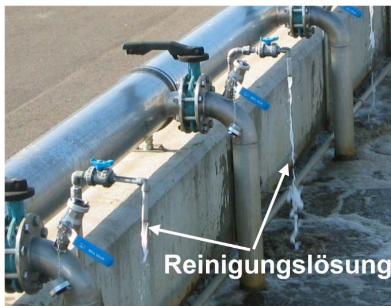
Abbildung 12: Entleerung über die Entwässerungsleitungen
