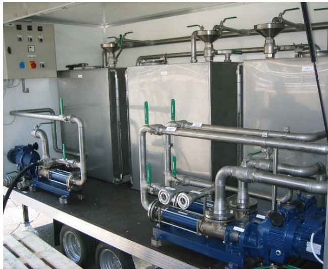
Abbildung 9: Aufbau der mobilen Reinigungsanlage
