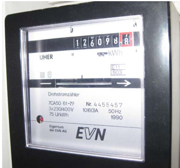
Abbildung 1: Drehstromzähler (kWh Zähler)
